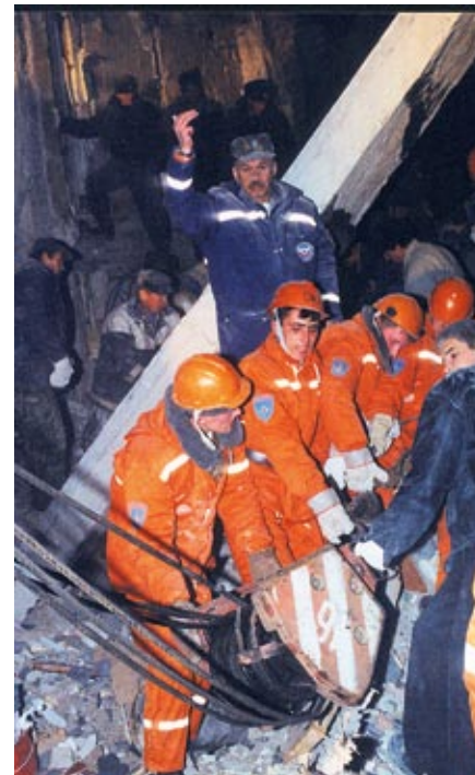
13 июля 2001 г. в Ростове-на-Дону из-за нарушения правил техники безопасности при производстве строительных работ произошло обрушение перекрытия реконструируемого четырехэтажного административного здания «Дон-агропромснаб». Сигнал об этом поступил в 11:57. В момент трагедии рабочие ремонтировали актовый зал на втором этаже, 11 из них находились внутри помещения. В результате трагедии пострадало 14 человек, 7 из них были госпитализированы с различными травмами. Погибло 2 человека.
